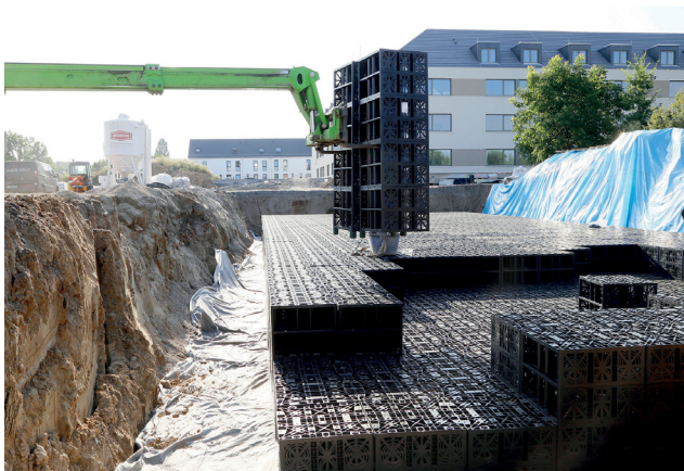
Bild 1: Dezentrale Regenwasserversickerung (Quelle: Otto Graf GmbH)
