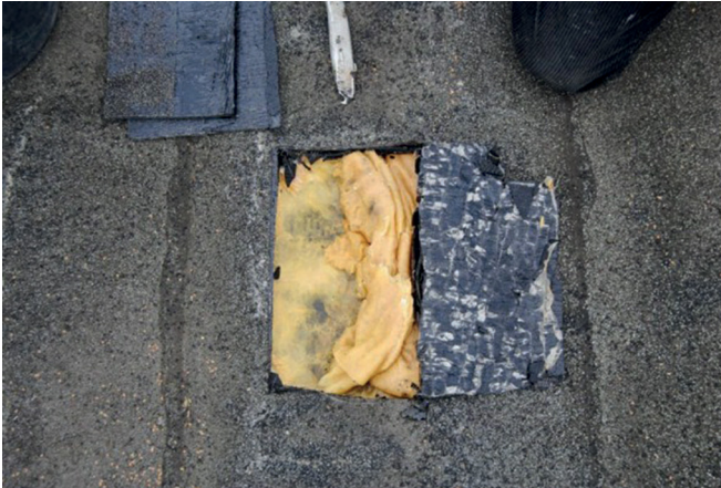
Bild 3: Unbemerkt zerfallene, aufgelöste Mineralfaserdämmung (Quelle: Jürgen Lech, BFD Essen)
