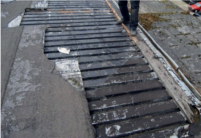
Bild 1: Im vorderen Bereich ist die Traufbohle ergraut, verfault, die Oberfläche des Trapezbleches dunkler, zum Teil verrostet. – Primäre Ursache: nicht erfolgte Instandsetzung (Quelle: Jürgen Lech, BFD Essen)
