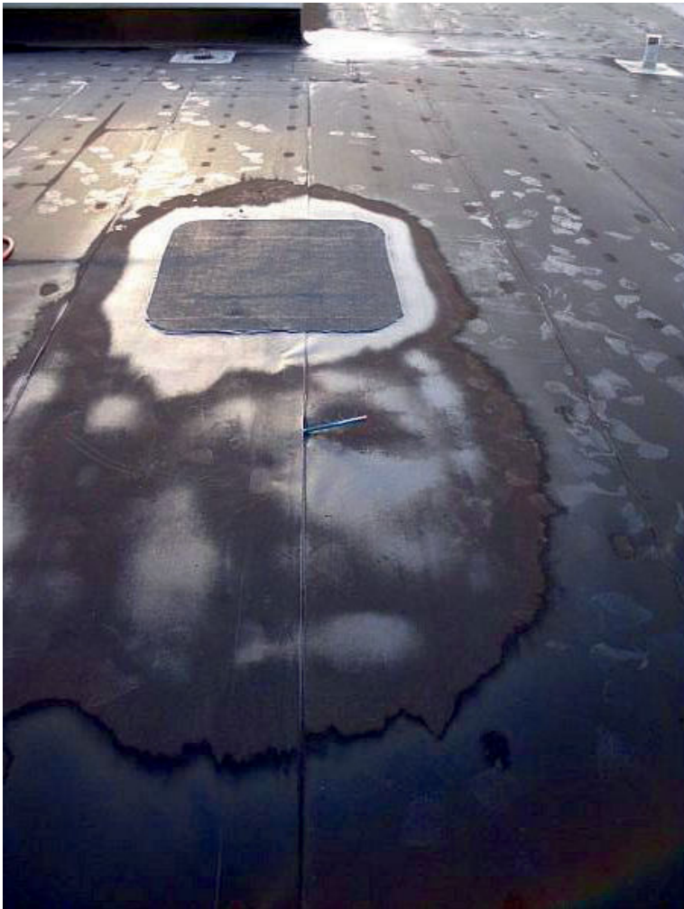
Bild 2: Etwa sechs Jahre alte Dachabdichtung mit einlagiger (Bitumen) Bahn – Naht unzureichend geschlossen (Quelle: Jürgen Lech, BFD Essen)
