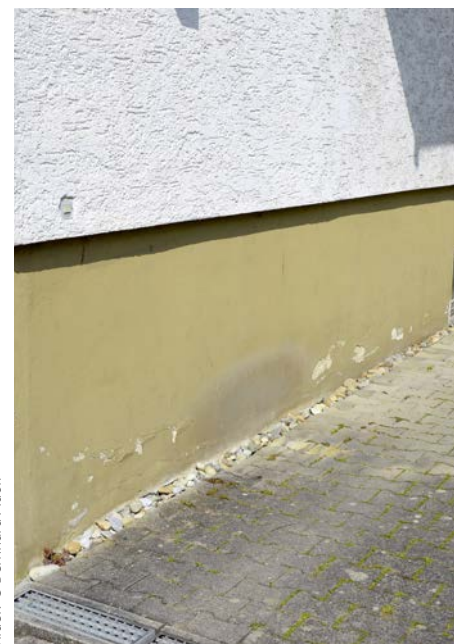
(2) Beschichteter Altputz ohne Abdichtung
