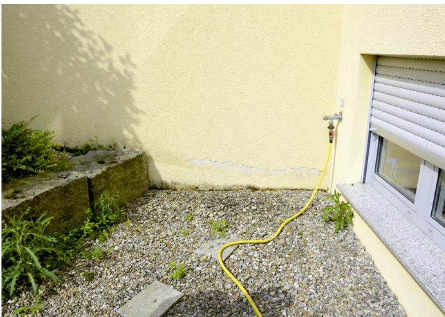
(1) Aufsteigende Feuchte und fehlende Abdichtung
