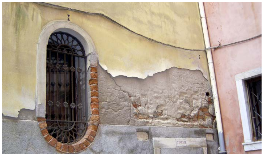
(5) Aufsteigende Feuchte hinter dichtem Zementputz
