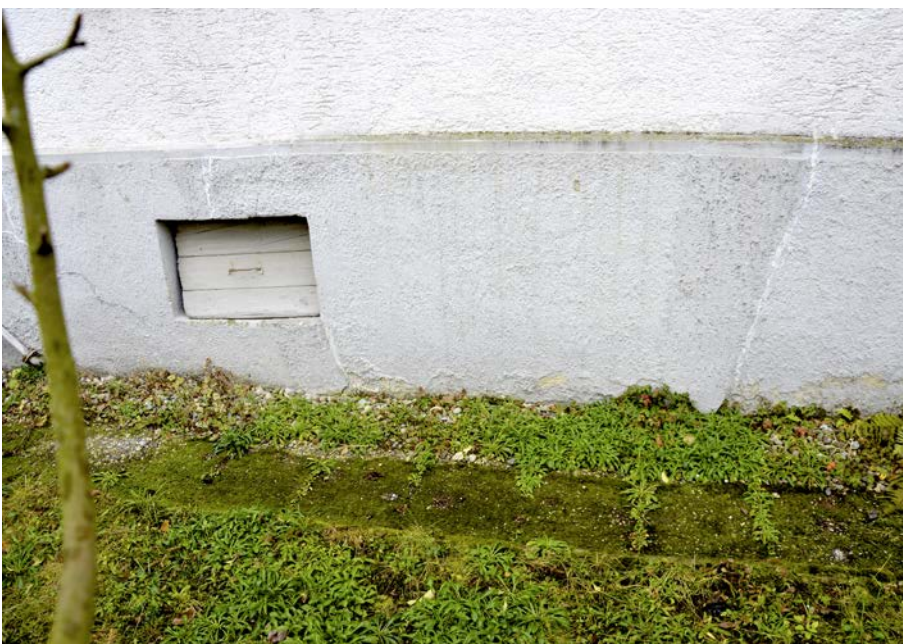
(3) Risse in der Sockelzone
