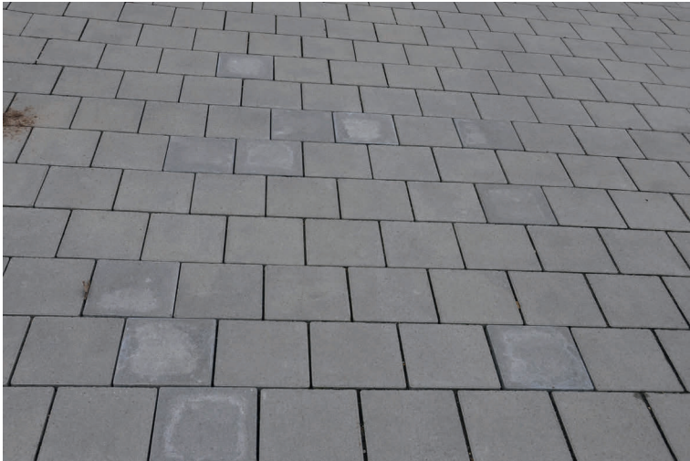
Bild 4: Deutlich sichtbar: die bräunlich-gelben Verfärbungen sowie auch die vorhandenen Ausblühungen auf bereits ausgetauschten Pflastersteinen (Quelle: Christine Andres)
