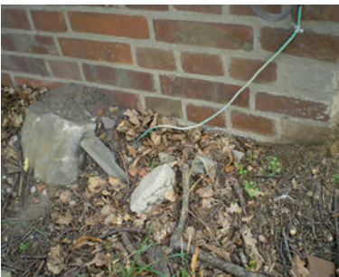
Abb. 4.5-4: Behelfsmäßige Erdungsanlagen, Quelle: VGH Versicherungen
