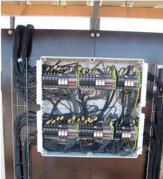
Abb. 4.5-11: Kabelführung Überspannungsschutz mangelhaft, Quelle: VGH Versicherungen
