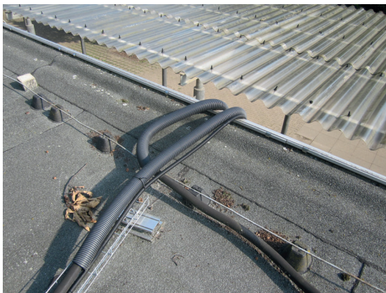
Abb. 4.5-5: Trennungsabstand nicht eingehalten, Beispielbild 1, Quelle: VGH Versicherungen
