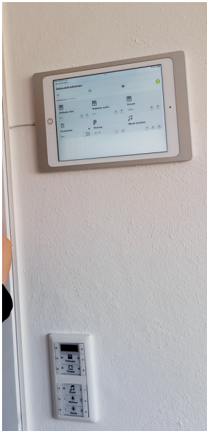
Abb. 6.5.2.4-3: Tablet für die KNX-Steuerung (Quelle: HFW, Musterwohnung AWO Nordhessen, Kassel)
