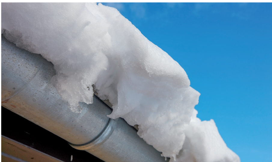
Gefährliche Dachlawine – das Gewicht von Schnee und Eis auf dem Dach wird oftmals unterschätzt.
