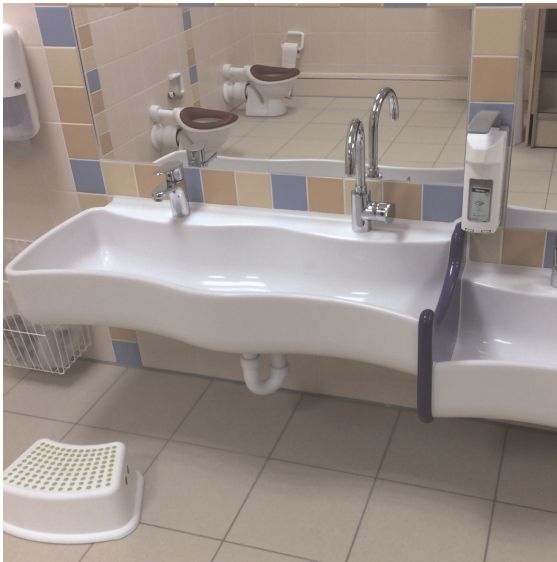
Abb. 5.2-1: Waschraum in einer Kinderkrippe, Quelle: HyCo Mück
