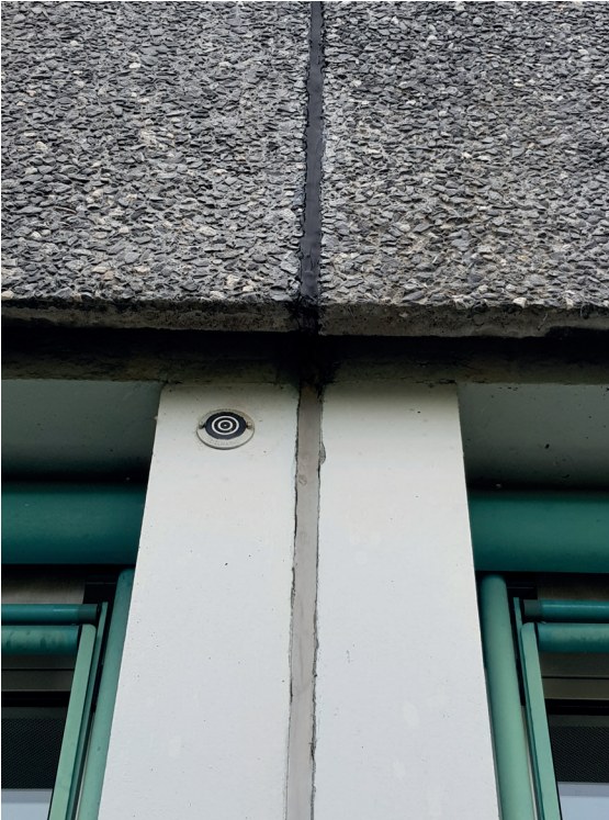
Abb. 2.2-1: Mit Dichtstoff abgedichtete Fuge, Quelle: Schmidt
