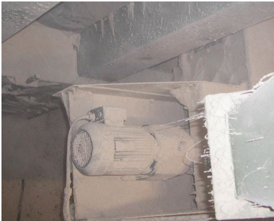
Abb. 10.5.4.4-1: Motor mit unzulässiger Staubbelastung (Mühlbetrieb), Quelle: VGH Versicherungen
