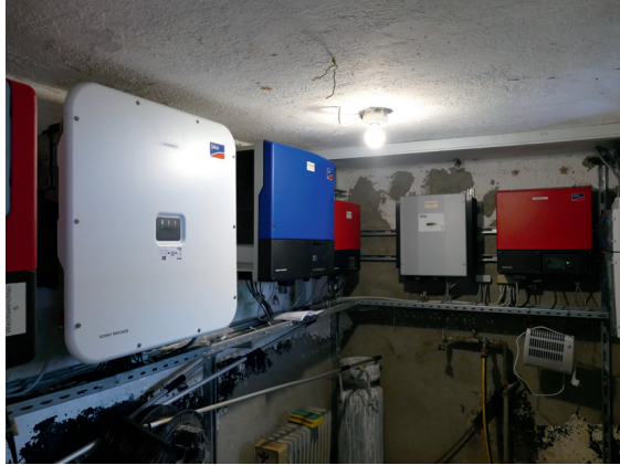
Abb. 3.7-5: Mangelhafte Montageabstände in einem viel zu kleinen Raum, Quelle: SV Schröder
