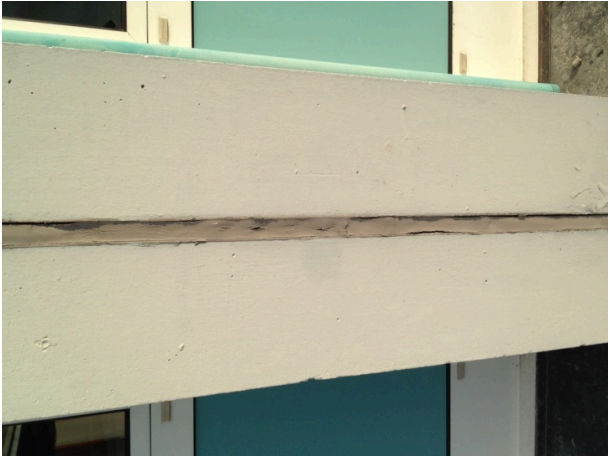
Bild 6: Bewegungsfuge eines Bauwerks; hier: Gebäude A des Campus Paul-Bonatz-Straße der Universität Siegen. Quelle: Prof. Dr. Peter Schmidt
