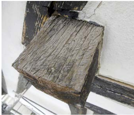
(8) Vor der Sanierung: Ungeschützt auskragender Balkenkopf
