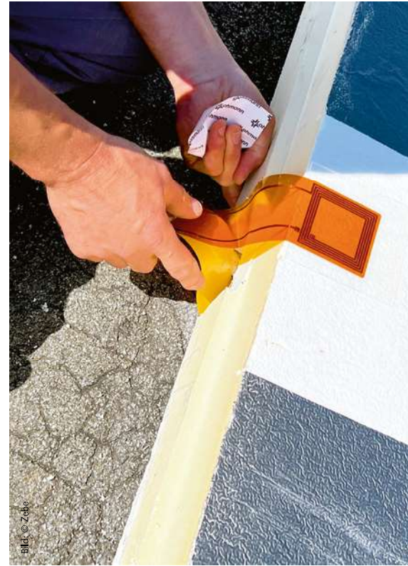
2 | Die Feuchtesensoren werden so eingebaut, dass sie unter der Wärmedämmung auf der Dampfsperre bzw. dem Altdach liegen.
