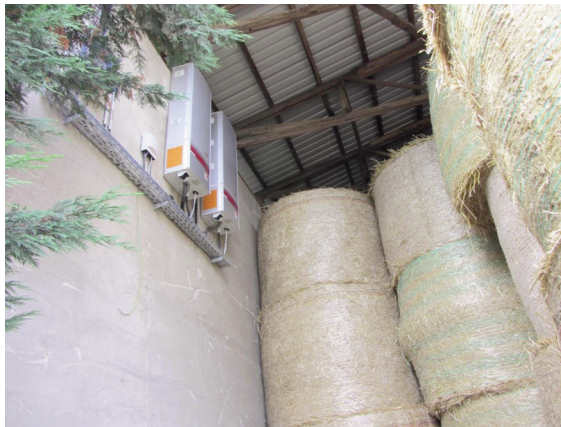
Abb. 10.5.4.1-2: PV-Wechselrichter in einem Strohlager, Quelle: VGH Versicherungen
