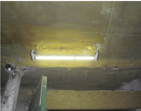
Abb. 10.5.4.3-2: Leuchten mit brennbarem Dämmmaterial „eingeschäumt“, Quelle: VGH Versicherungen
